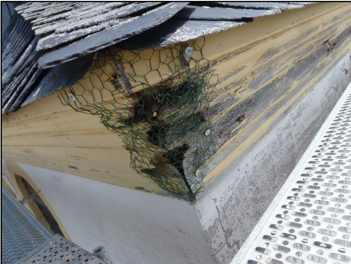
Schadhafte Turmtraufe auf der Nord/West Seite, provisorisch geschützt mit Gitterdraht vor den Dolen
