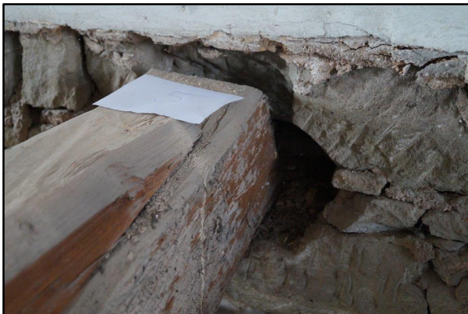
Schadhaftes Auflager der zweiten Empore
